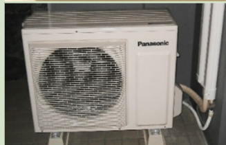
エアコン・室外機
