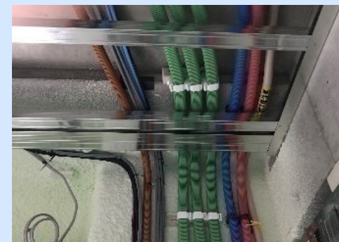
天井裏の配管
