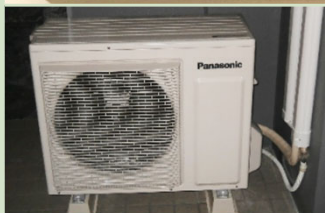
エアコン・室外機
