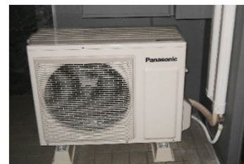
エアコン・室外機
