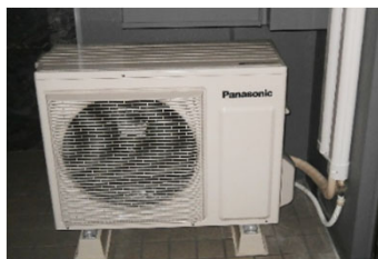
エアコン・室外機
