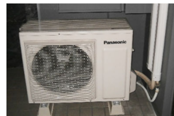
エアコン・室外機
