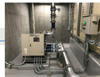
受水槽・給水ポンプ
